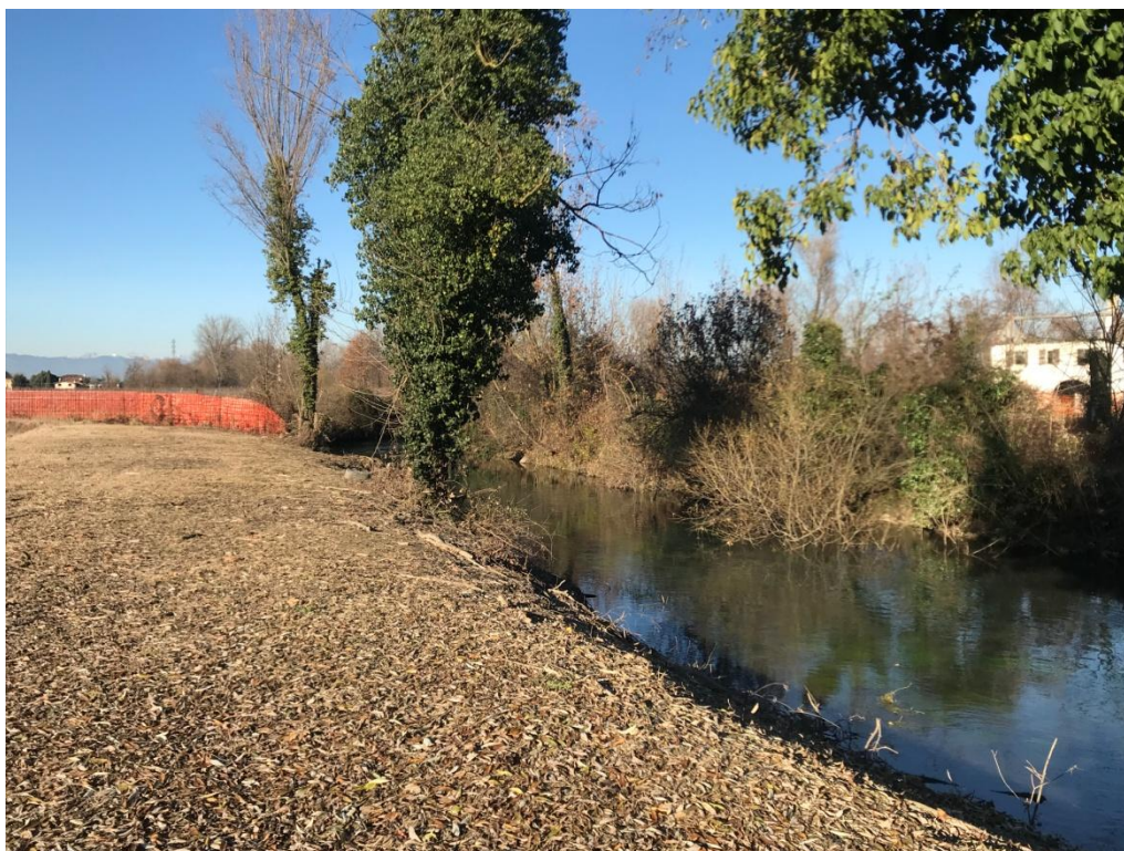
Figura 4 – Il tratto di sponda del fiume Melma interessato dai lavori di abbattimento e spianamento. Sulla sponda opposta si nota la continuità della vegetazione integra, non toccata dai lavori. Sullo sfondo si vede la rete del cantiere della lottizzazione
